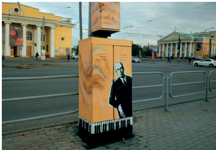
Рис. 16. Граффити на трансформаторном шкафу [Роспись шкафа у памятника Прокофьеву]
